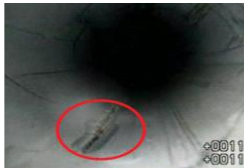
케이싱 내 절단부를 방치하여 지하수 오염 우려 (공내 CCTV 촬영)
