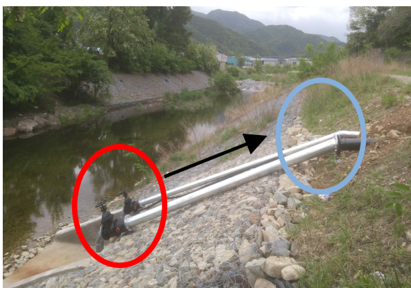
송수관로 제수변 설치 위치 부적정 (홍수시 작동 곤란 우려)
