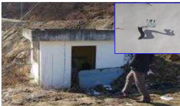
전기단선 및 출입문 파손
