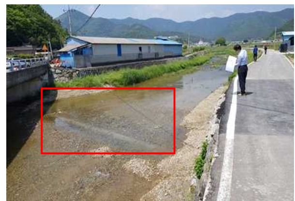
집수암거로 사용되는 유공관이 노출되어 하천바닥 토사, 부유물 등 유입 가능
